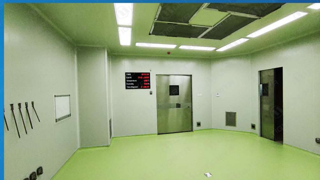
RSUD dr. R. Goeteng Taroenadibrata, Jawa Tengah Project Ruang MOT / OK
