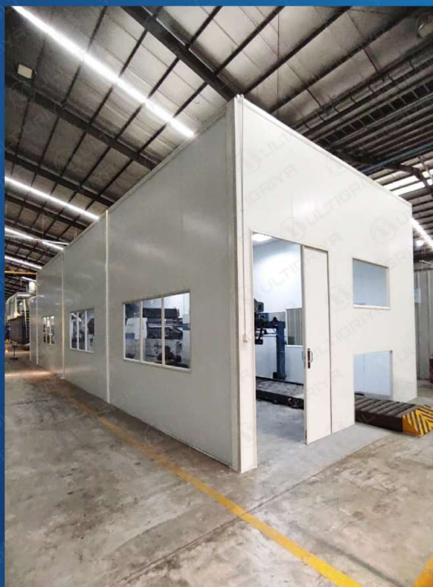
PT. DBP, Banten Project Clean Room Ruang Mesin Produksi
