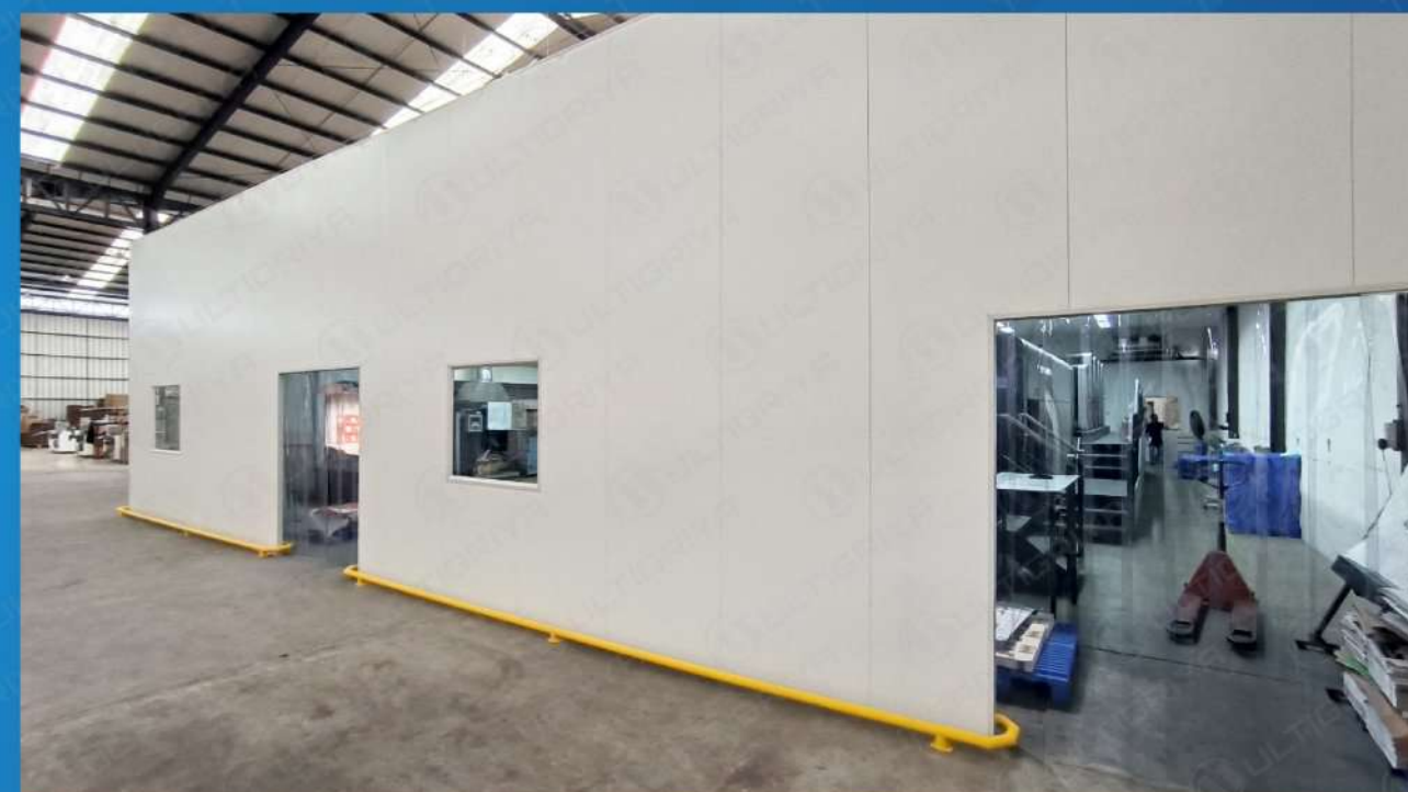
PT. APG, Banten Project Clean Room Ruang Mesin Produksi
